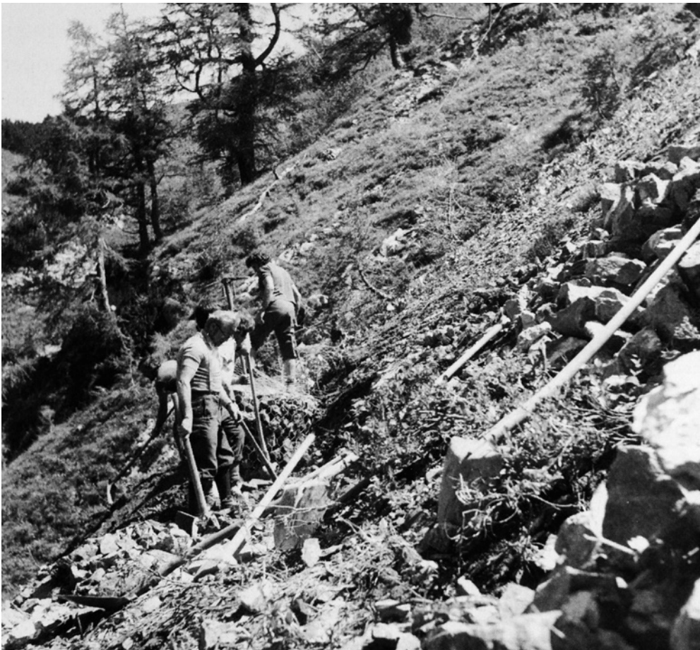
Hangsicherungsarbeiten im Jahr 1974 am Poliloch durch die Genossenschafter der Alp Gritsch, Gemeinde Schaan.
