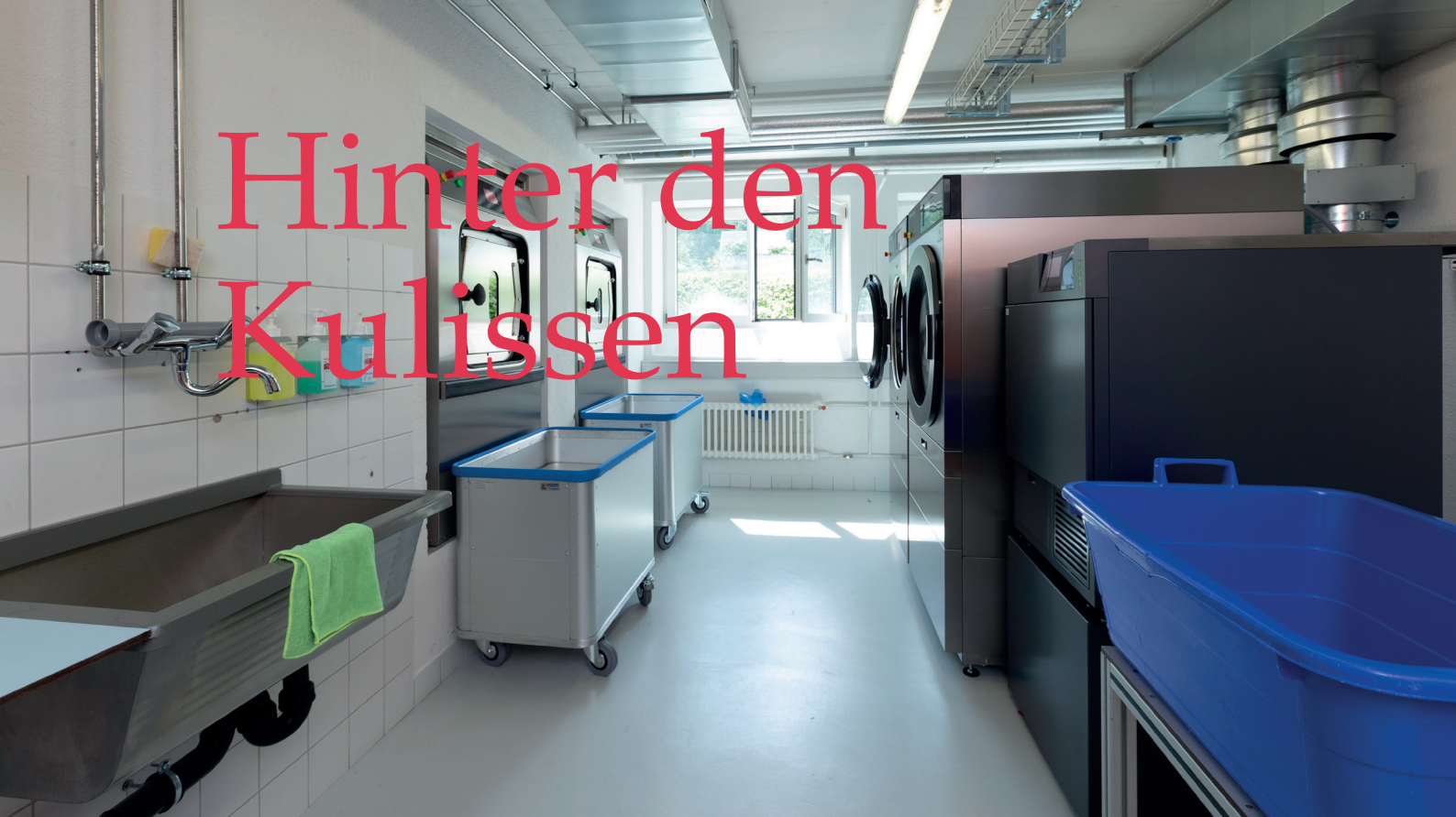
Sauberbereich mit links zwei neuen Trennwand-Waschmaschinen, rechts den grossen Tumblern
